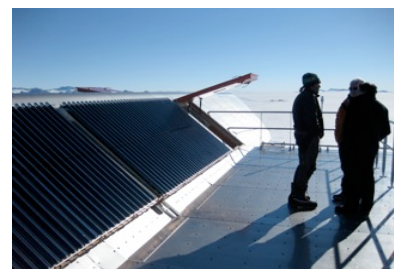
Röhrenkollektoren vom Typ TUBO 12 CPC auf dem Dach der Polarstation
